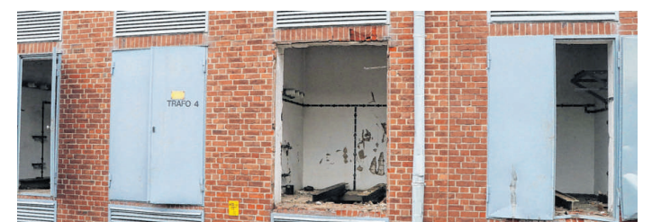
So wüteten die Metalldiebe: Aus diesen Fächern wurden Transformatoren der ehemaligen Teppichfabrik entwendet. Foto: Jann
